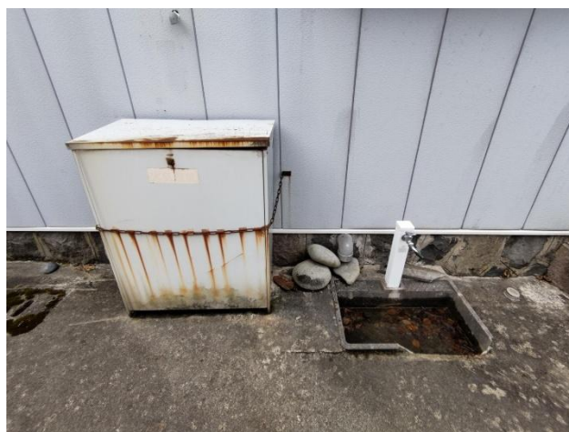
プロパンガス置き場、水道
