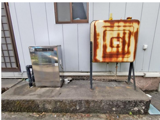
灯油ボイラー ※故障中、灯油タンク
