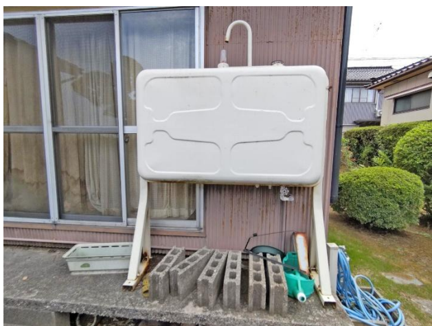
灯油ボイラー
