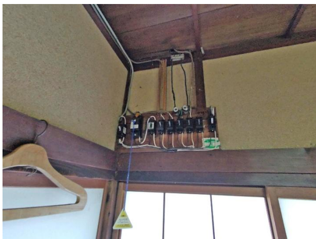
Ⅰ階 和室 6帖 A 配电箱
