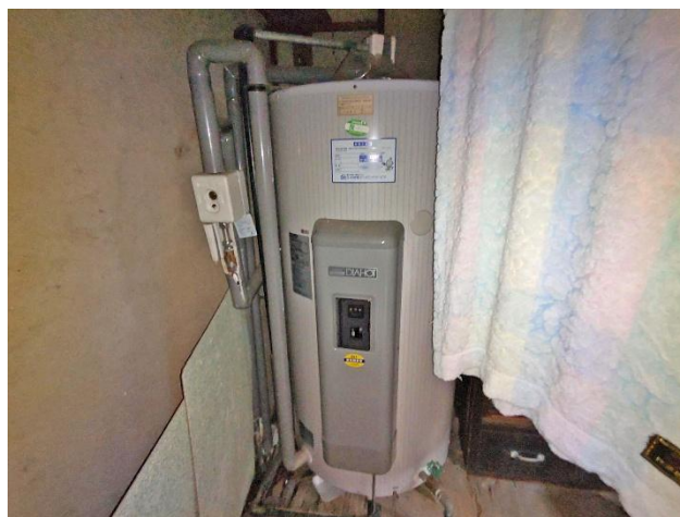
Ⅰ階 納戸 電気温水器
