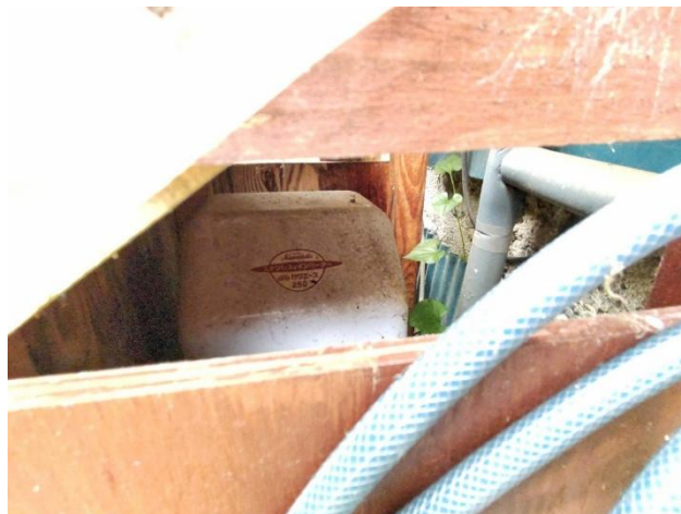
自家井戸ポンプ
