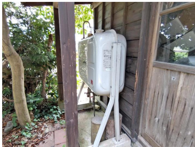
納屋 B 灯油タンク
