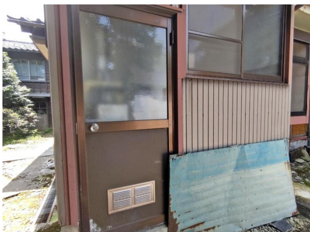
灯油ボイラー置き場
