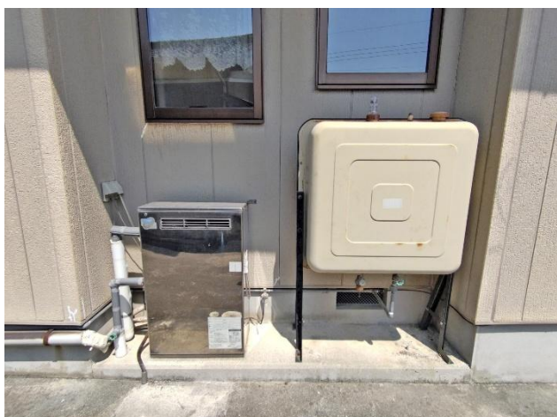
灯油ボイラー、灯油タンク
