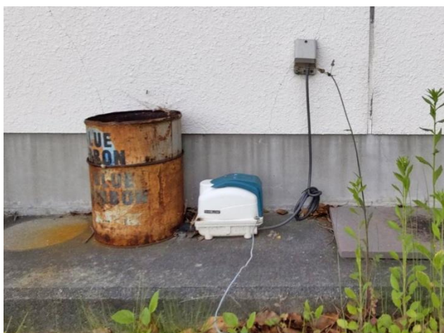
浄化槽ブロー
