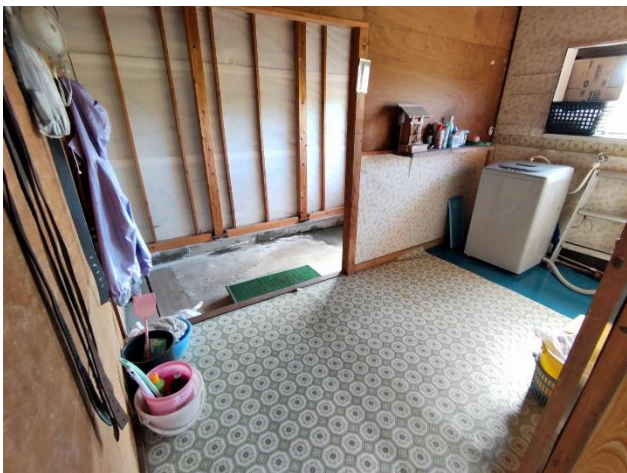
1階 洗濯機置き場
