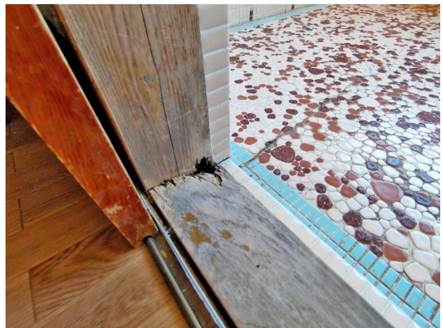
1階 浴室入口 木枠の傷みの様子
