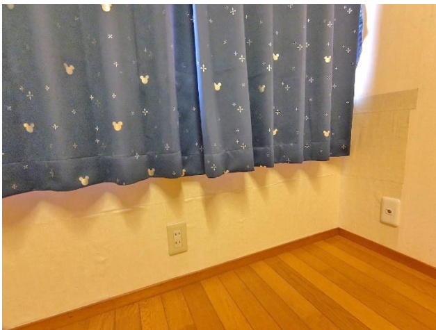
2階 洋室6帖B 窓下の壁
