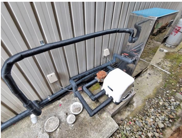
灯油ボイラー、自家井戸
