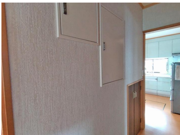
1階 配電盤、階段下収納
