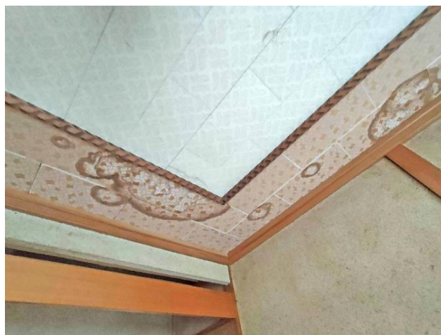
Ⅰ階 玄関 天井雨漏り跡
