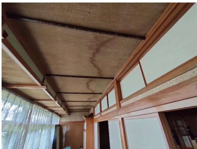
Ⅰ階 広縁 天井雨漏り跡
