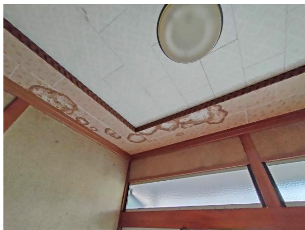
Ⅰ階 玄関 天井雨漏り跡
