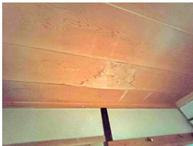
Ⅰ階 和室8帖 天井雨漏り跡
