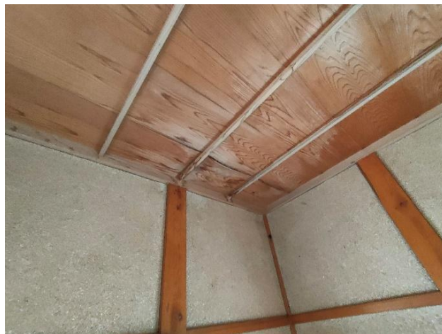
Ⅰ階 和室6帖D 天井雨漏り跡
