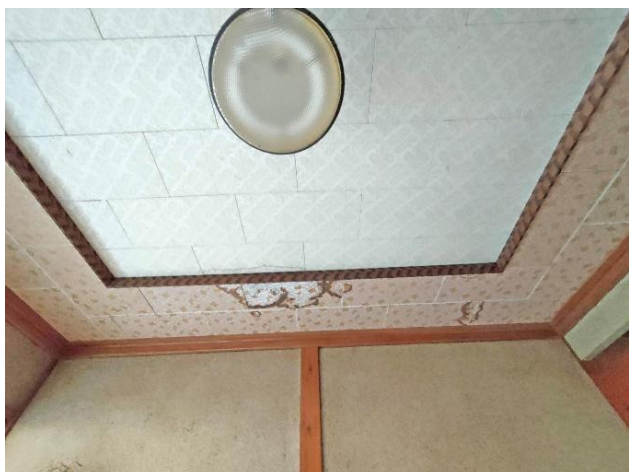
Ⅰ階 玄関 天井雨漏り跡
