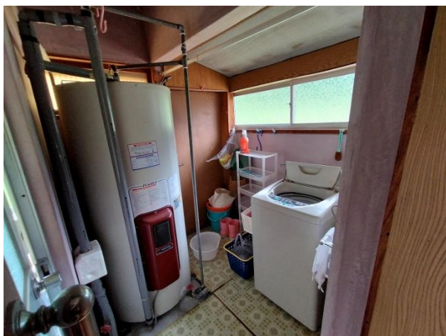
Ⅰ階 電気温水器、洗濯機置き場
