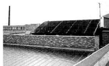
朝日町の新エネルギー導入施設「らくちー」風力発電施設（上）と太陽光発電施設（下）
