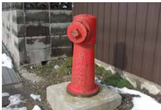
住宅密集地等に設置されている消火栓
