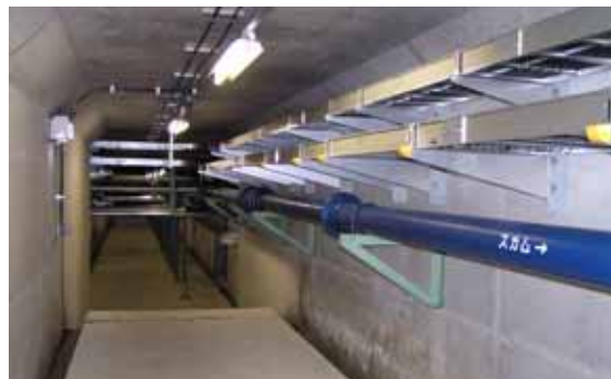
下水処理場内の管廊
