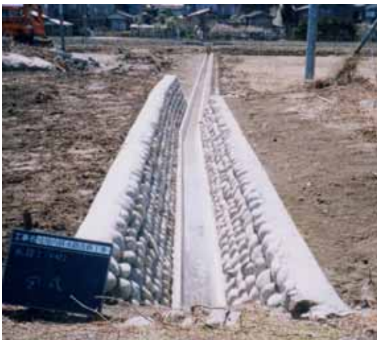
交付金によって整備された排水路
