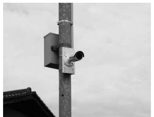
設置されている防犯カメラ
