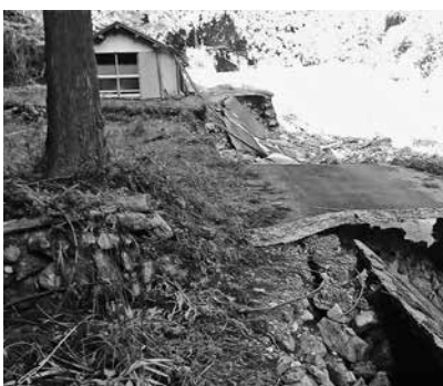
台風21号による被害箇所 (林道蛭谷線)
