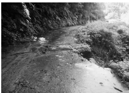
7月の町道湯ノ瀬北又線の災害現場
