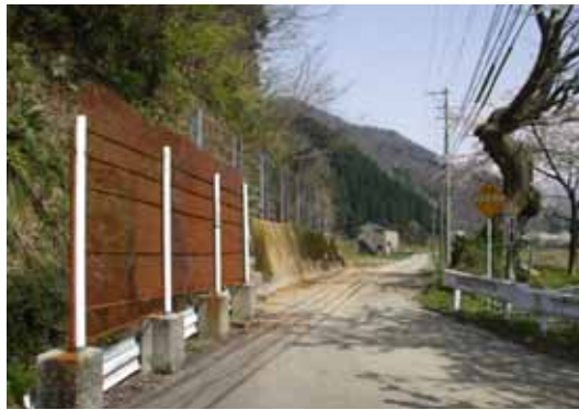
町道蛭谷東部線の危険箇所
