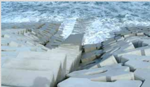
高波により崩れた階段式護岸（境内内）
