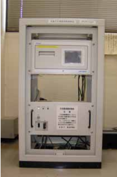
役場内に設置してある震度計
