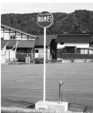
整備された防火水槽
