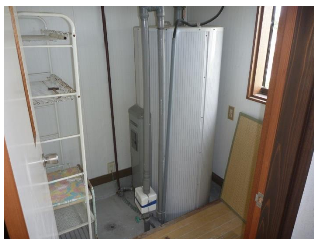
1階 電気温水器
