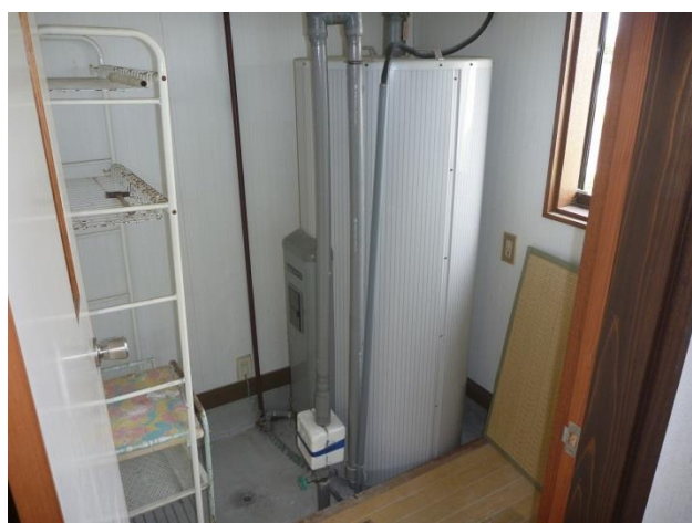
1階 電気温水器
