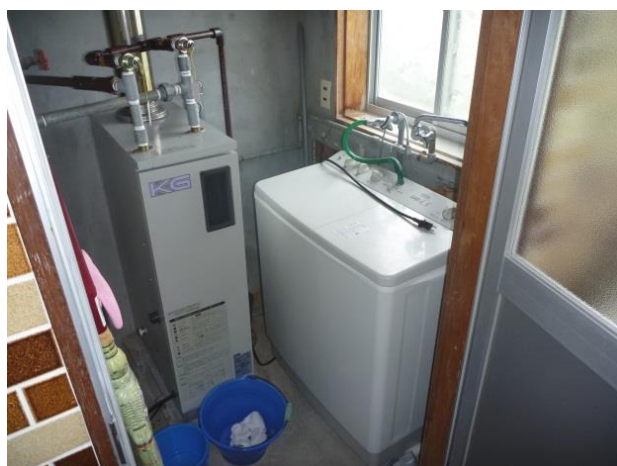
1階 洗濯機置場
