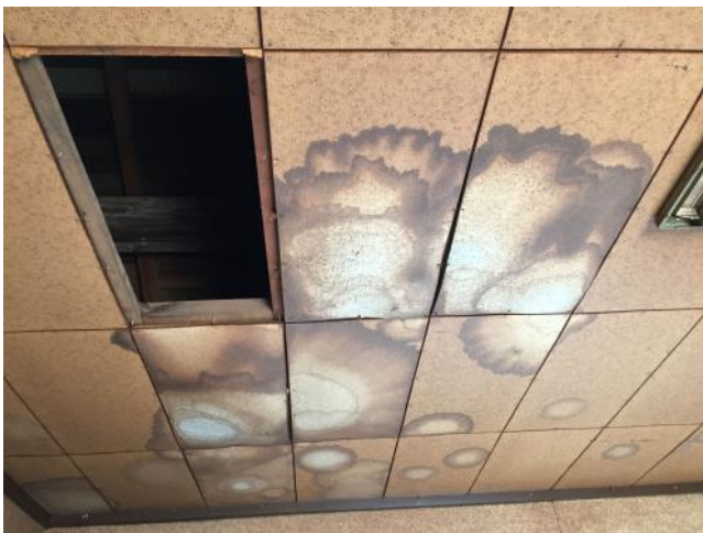
2階 洋室天井雨漏り跡(屋根は補修済み)
