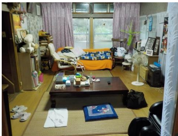
1階 和室12畳 ※一部床沈みあり
