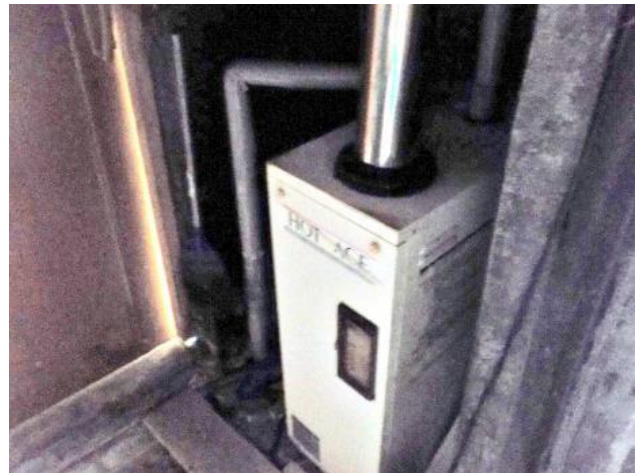
1階 ボイラー (勝手口横)
