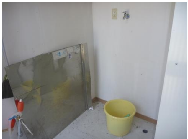
1階 洗濯機置場
