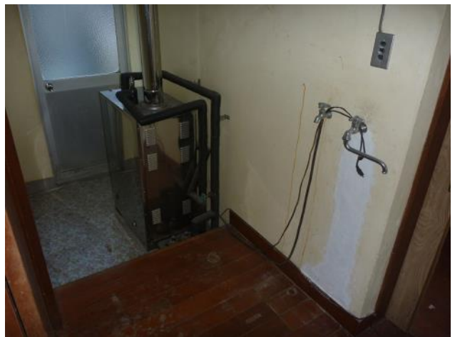
1階 洗濯機置場
