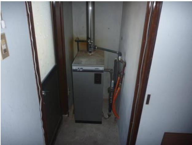
1階 台所横勝手口・灯油ボイラー
