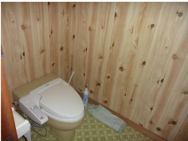
2階 トイレ ※故障
